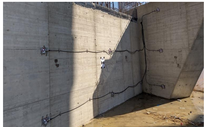
Erddrucksensoren an der Widerlagerrückwand mit Messmarken
